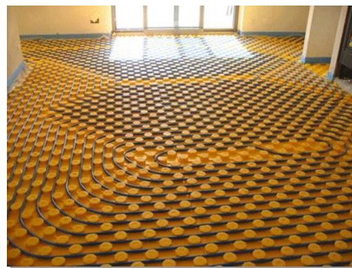
Figura 20. Serpentina del riscaldamento a pavimento
